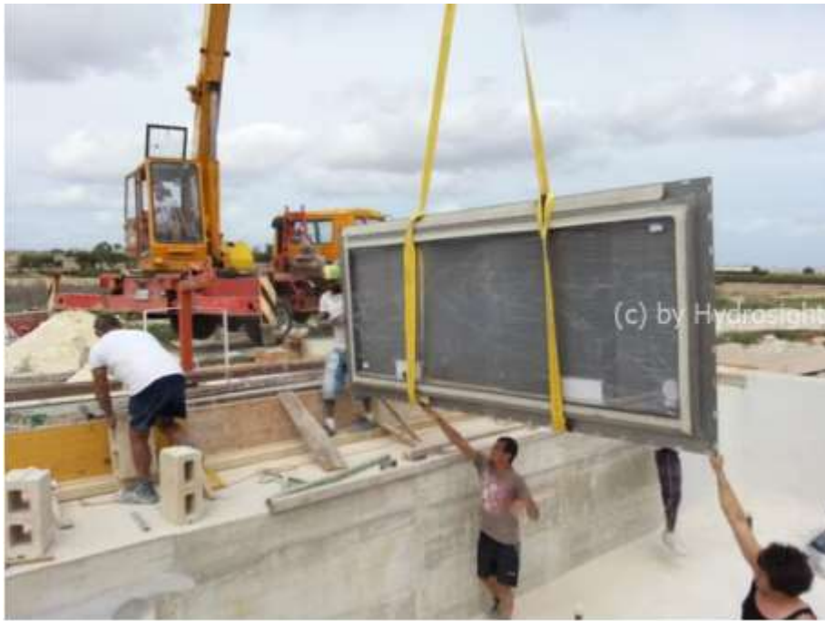
Ventanas subacuática colgando con correas amarillas. La grúa que la sostiene se puede ver atrás.
